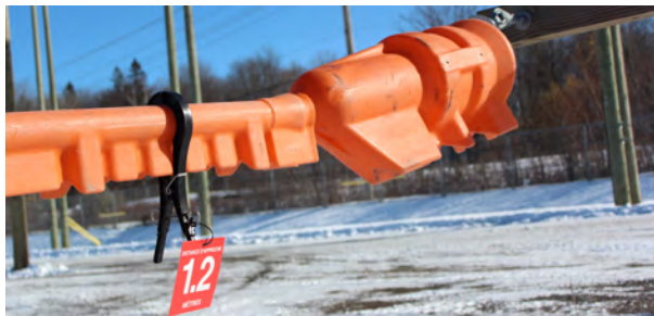
Protecteurs correctement installés
