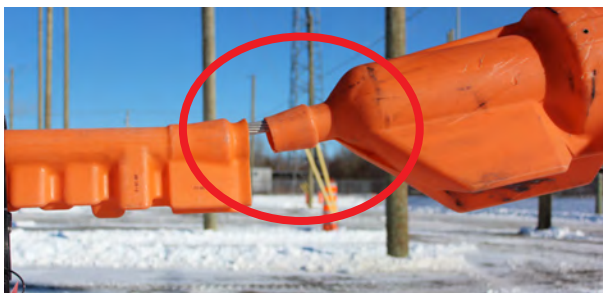
Partie de conducteur mise à nu à cause du mauvais emboîtement des protecteurs
