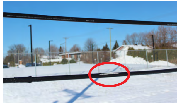
Gaine de conducteur endommagée
