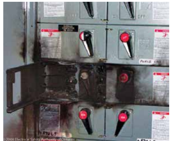
PHOTO: ELECTRICAL SAFETY AUTHORITY OF ONTARIO La victime a subi des brûlures au 2 e et 3 e degré au cou, au visage et aux mains suite à un mauvais branchement dans le multimètre.
