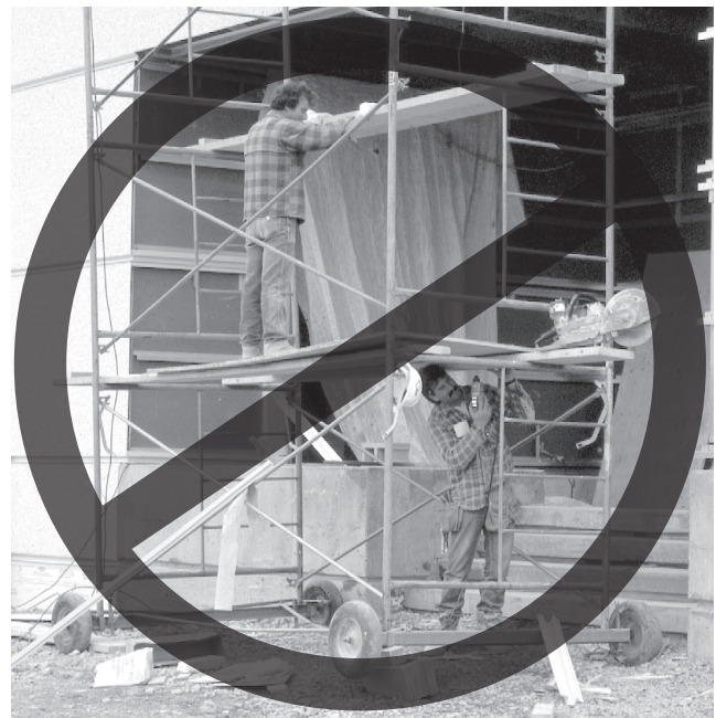
Empilement d'objets sur des planchers non conformes
