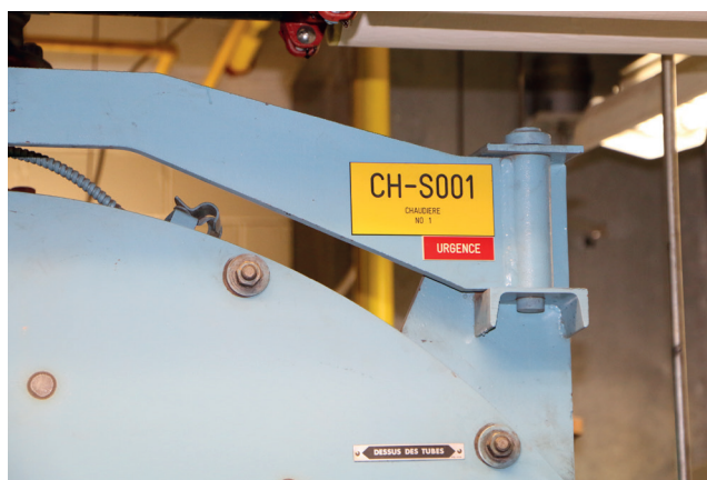
Exemple d'identification de l'appareillage
